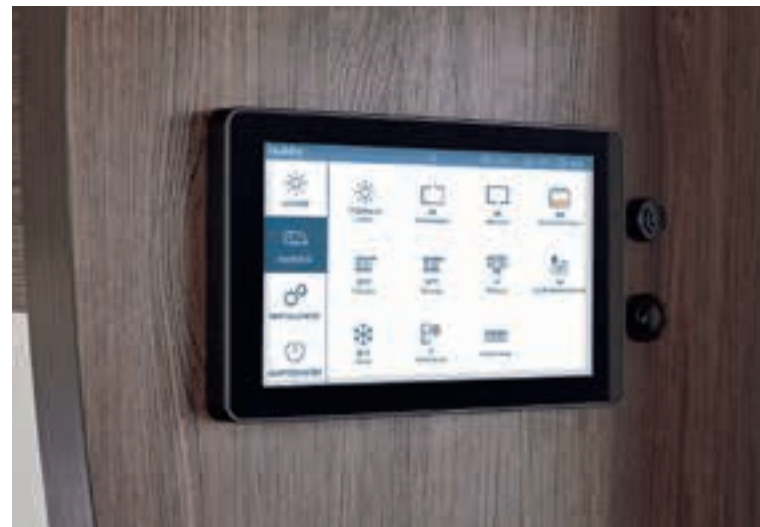
BETJENINGSPANEL TIL STYRING AF INTEGRERET TEKNIK
